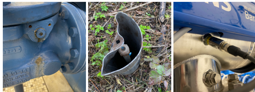
undichte Drosselklappe defekte Schieberarmatur defekter Fühler an der UV-Anlage
